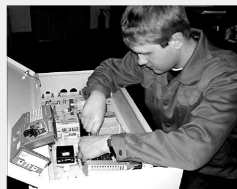
Вес шкафа управления освещением — 20–30 кг (зависит от модификации). У ближайших конкурентов аналогичный шкаф весит в шесть раз больше и стоит в два раза дороже.
